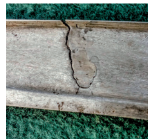
Fot. 2. Pęknięcia przy spoinie
